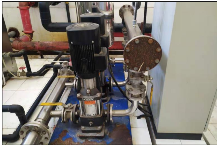
图3 地下一层室内水泵房及减震基础
